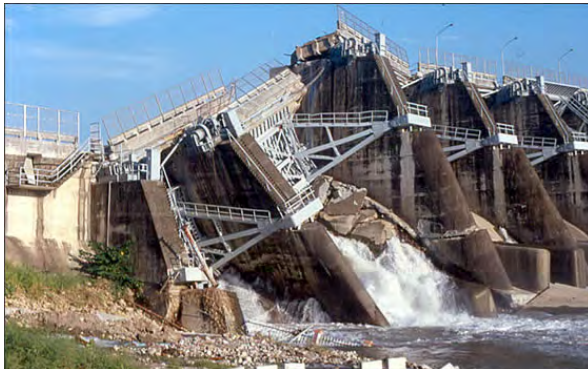
شکل ۴- تخریب سد به علت وقوع زلزله [۸]
